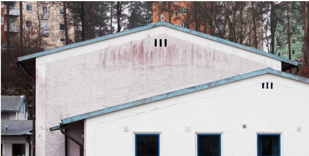
Bild 7. Exempel på missfärgad fasad. Missfärgningen är missprydande men påverkar inga andra funktioner i byggnaden. Foto: Pernilla Johansson, SP.
