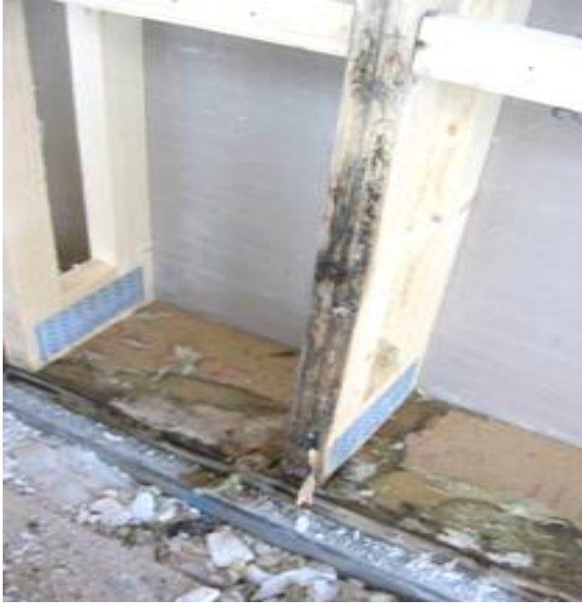
Bild 6. Inläckage av nederbörd i en ytterväggskonstruktion kan ge omfattande fuktskador. Bilden visar en frilagd yttervägg där vatten trängt in.
